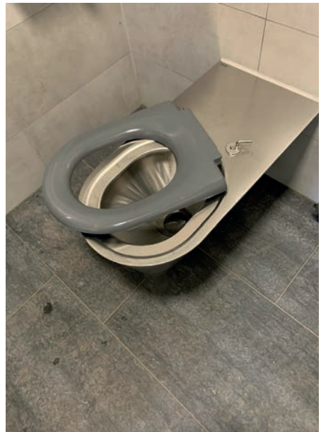
Beschädigte WC-Anlage am 1. August 2023.
