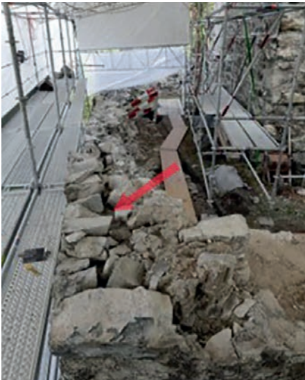
Abb. 2: Auf einer Länge von mehreren Metern zeigt sich, dass die Mauerschale der Mauer (8) nicht mit dem Mauerkern verbunden ist (roter Pfeil). Die eindringende Feuchtigkeit sorgte dafür, dass sich der Kalkmörtel stellenweise auflöste und nur noch aus Sand besteht. Dieser Bereich der Mauer musste bis auf eine stabile Steinlage abgebrochen werden.
