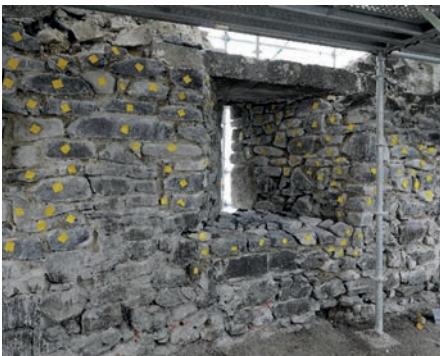
Abb. 3: Gelbe Markierungen: Diese Steine wurden ersetzt.
